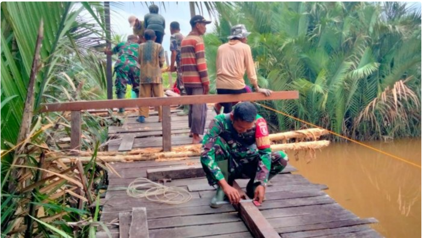
Babinsa Koramil 1005-11/Tabunganen Bersama Warga Gotong Royong Perbaiki Jembatan Yang Rusak
